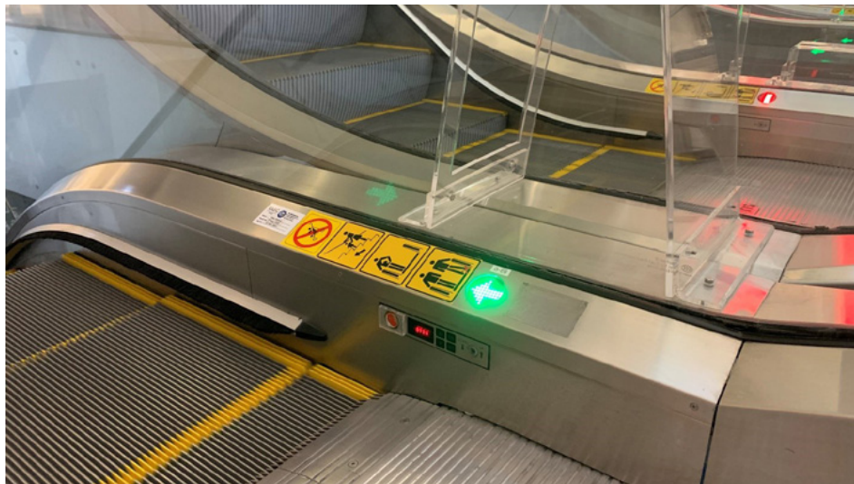
الشكل D.2 سلم كهربائي مزود بمستشعرات في مناطق البسطات العلوية والسفلية
